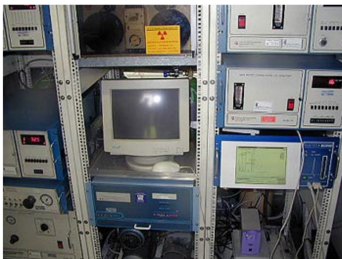
Figura 1 : Interno di una cabina di rilevamento
